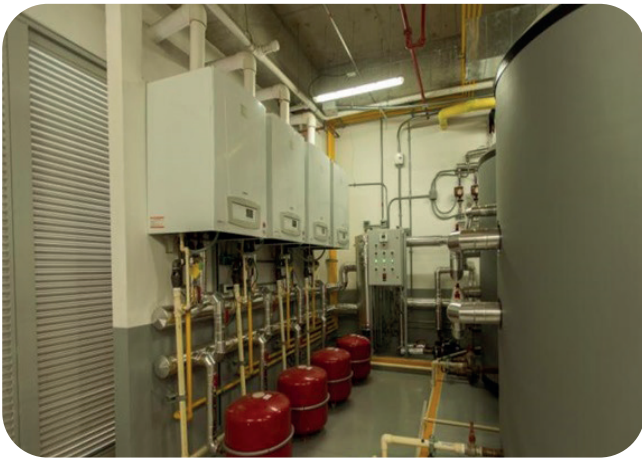
Central térmica calderas murales de condensación y acumulación
