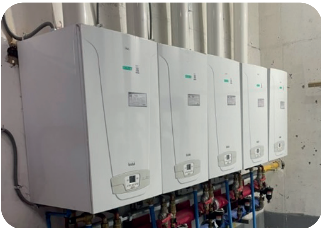
Calderas de condensación en cascada
