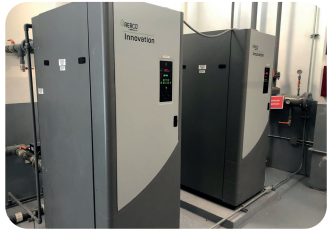
Central térmica de producción instantánea
